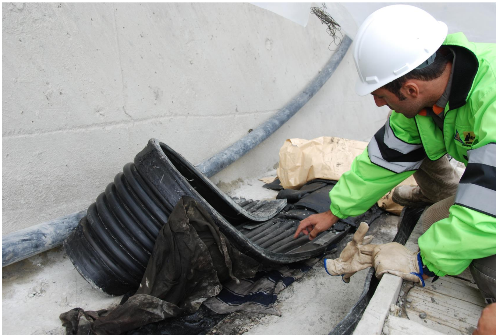
Presas Mazar – Junta Perimetral E. Fderecho: Sellos de caucho y material bituminoso
