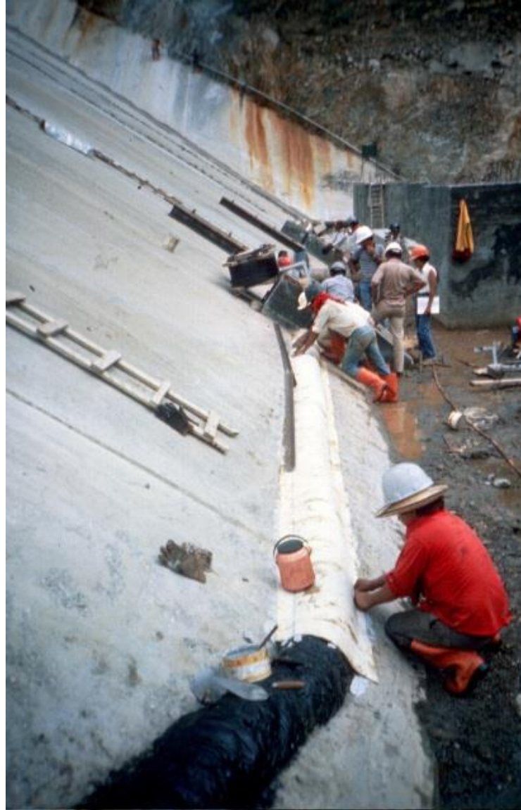
Presa Salvajina – Junta Perimetral y de extensión – 3a Línea de defensa: Igas
