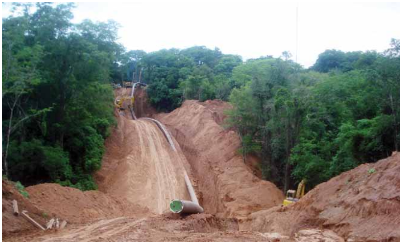
- PROYECCIÓN. La construcción del gasoducto comenzará al norte de la provincia de Salta, en Aguaray.
