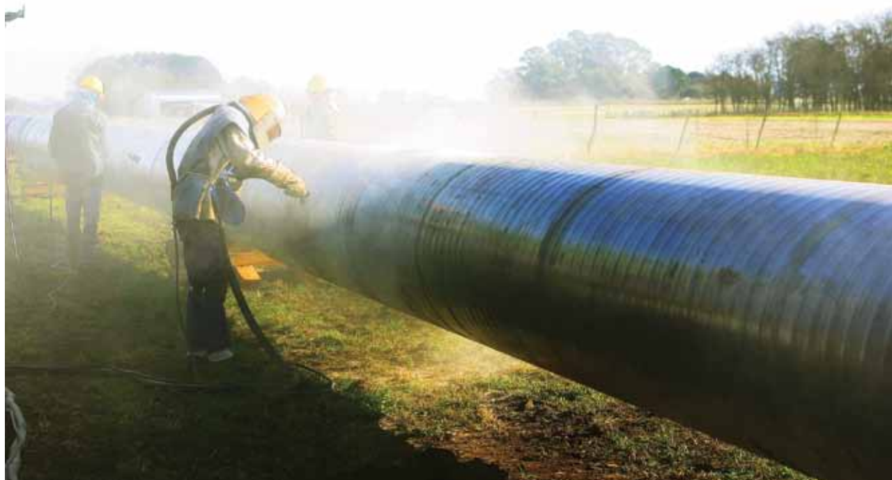
- PRESERVACION. Las posibles fugas de fluido y un eventual daño ambiental son las mayores preocupaciones.
