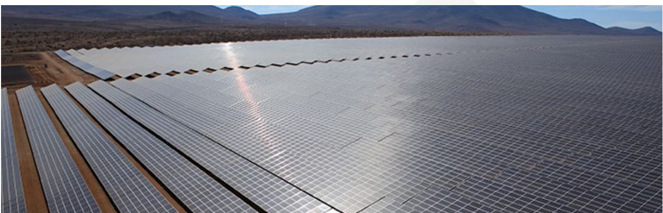
El Romero Solar PV Plant, Chile - Source: Acciona Energy
