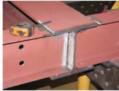
Unió soldada de perfil d'acer en la formació de bastiments de forjats de formigó
