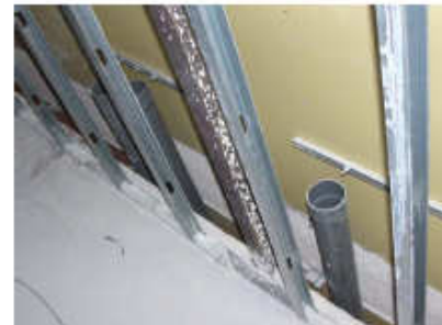
Espel de pes de muntants i baixants entre dues files de mòduls, amb estructura de reforçament
