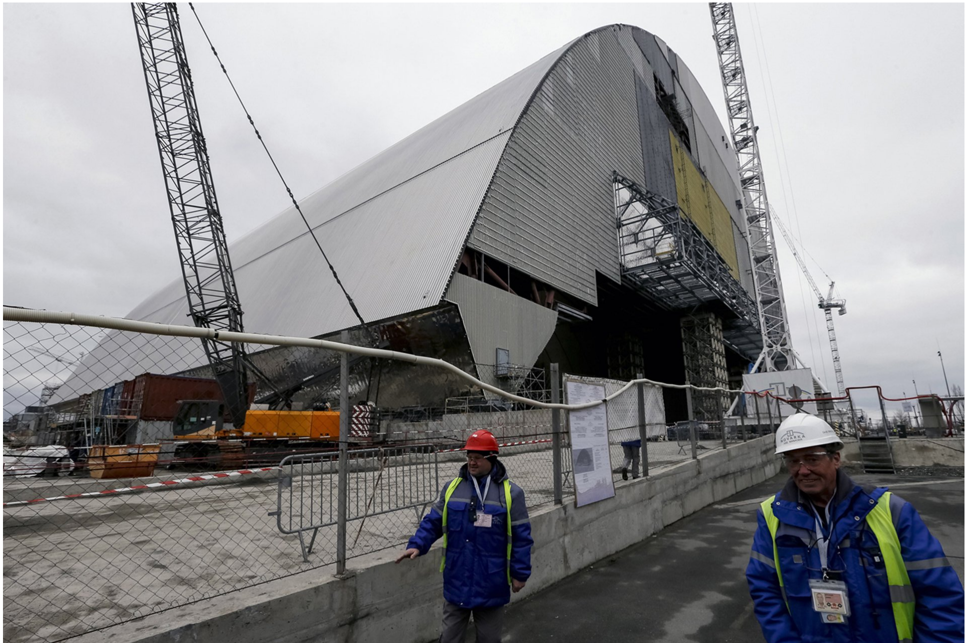
CUBIERTA ADICIONAL DE PROTECCIÓN CONTRA POSIBLES FUGAS DE RADIACIÓN
