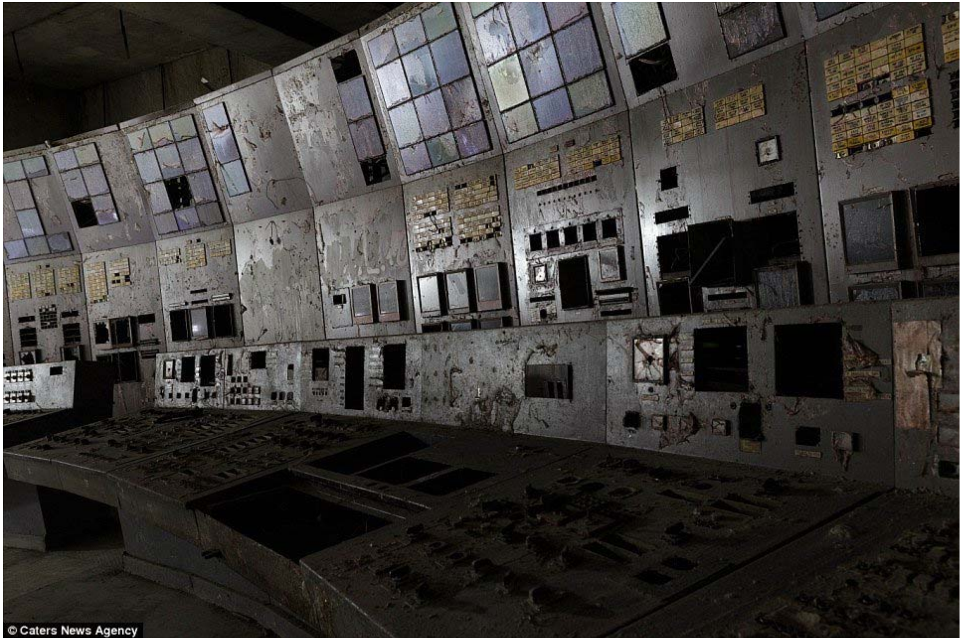
RUINAS DE LA SALA DE CONTROL DE LA CENTRAL
